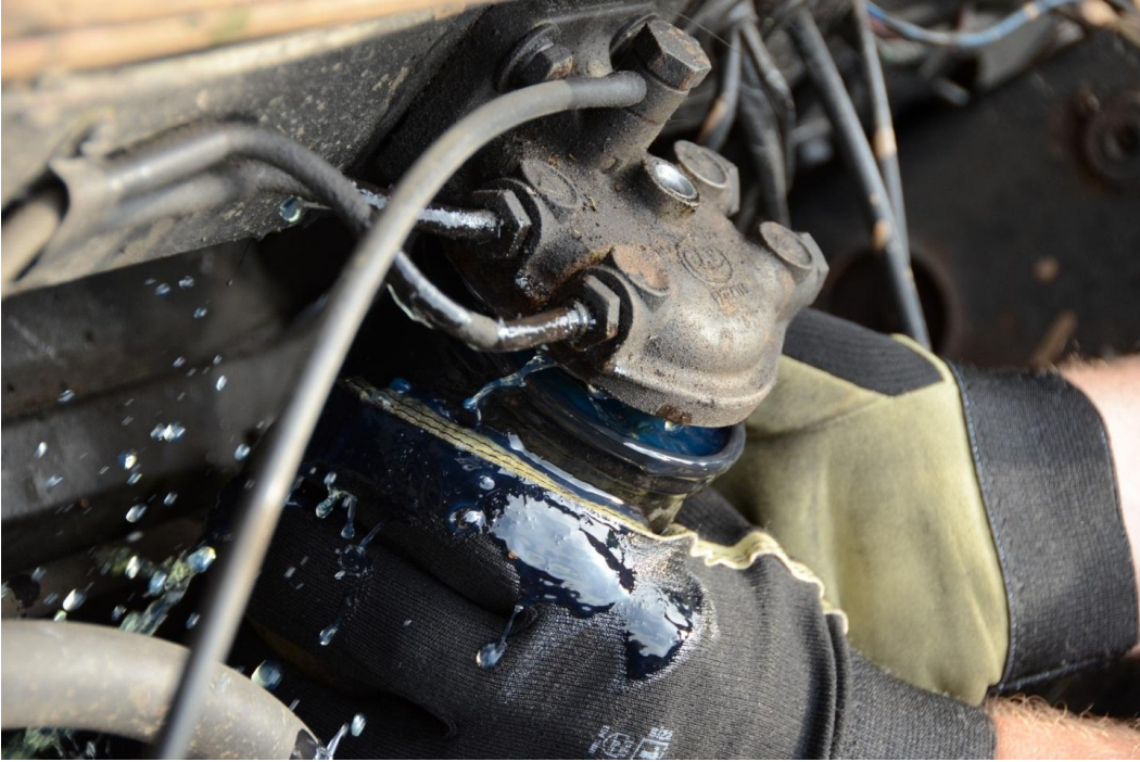
Billede 23: Bolten har sluppet og filteret er løs, det sviner
